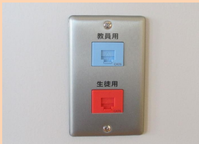
情報コンセント設置状況②
